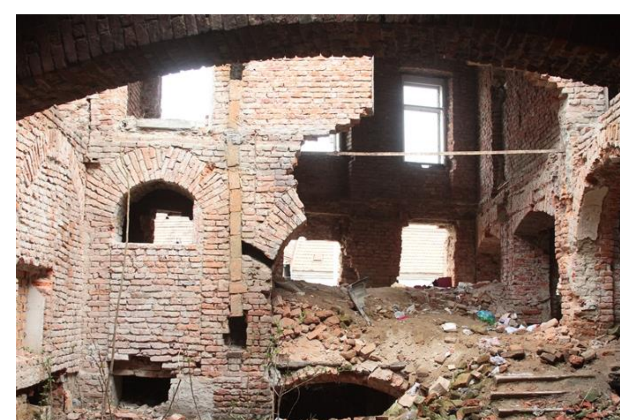
Fig. 10. Clădire deteriorată ca urmare a lipsei de întreținere - prăbușită în zona Piața Traian
