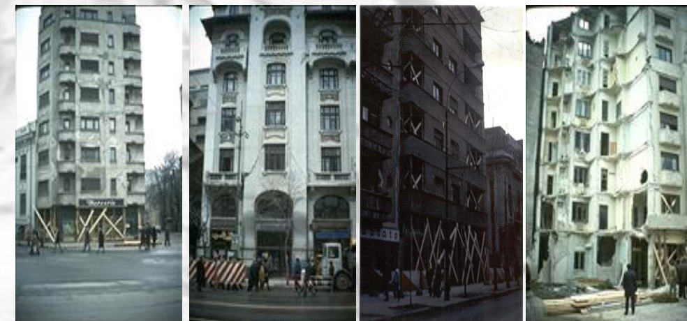
Zidărie cu schelet din beton armat (P+7E)-Bd. Magheru nr. 24 (Str. Cosmonauților colț cu str. Michelet); Structură din zidărie (P+5E)-Bd. Bălcescu nr. 26; Zidărie și schelet din beton armat (P+7E)- Bd. Kogălniceanu nr. 7 - 9; Clădire cu schelet de beton armat (P+7E)-Bd. Magheru nr. 5 (Franklin nr. 11)
