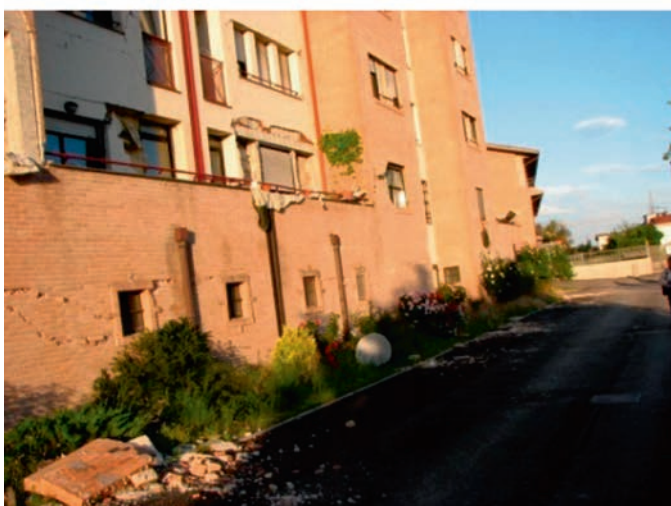
Elementele nestructurale care se pot desprinde de pe clădiri
