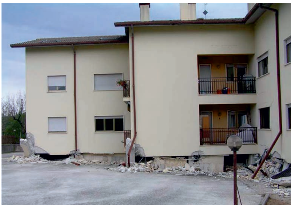
Distrugerea unei clădiri cu etaj slab, L'Aquila Italia, 2009
