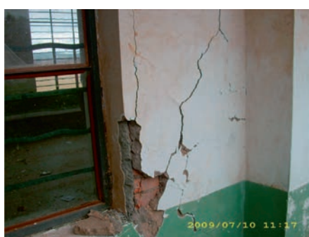
Detaliu al fisurării unui perete de cărămidă
