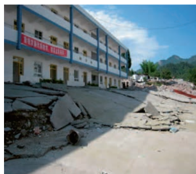
Ca urmare a deformării terenului, clădirea școlii a fost ridicată 3 m, în timpul cutremurului Wenchuan, 2008, China
