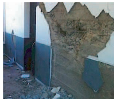
Avarii ale unui perete structural din beton armat, Constitución, Chile, 2010
