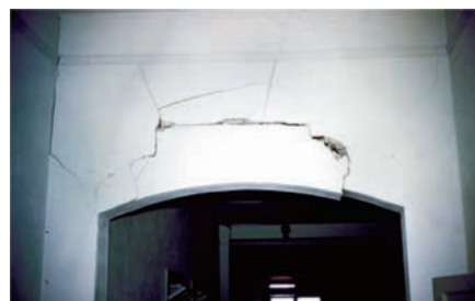
Zidărie de deasupra unui coridor, gata de a se prăbuși, California, 1952
