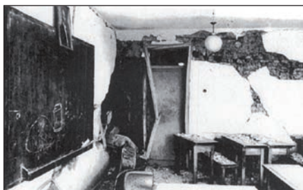
Interiorul unei clase într-o școală vulnerabilă, după cutremur (fără referință cutremur, sursa EERI, SUA)
